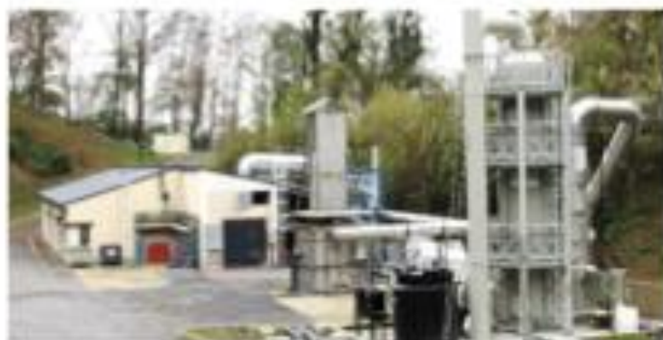
Plateforme STEEVE Sécurité
