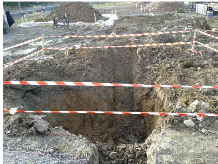
Découverte d'une zone impactée par les hydrocarbures
